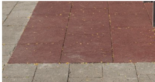
Rubber tegels verzonken t.o.v. bestaande verharding: beter resultaat, maar ingrijpende werken. De bestaande verharding verwijderen en een bed van stabilisé of aan gedrild steenpuin voorzien.
